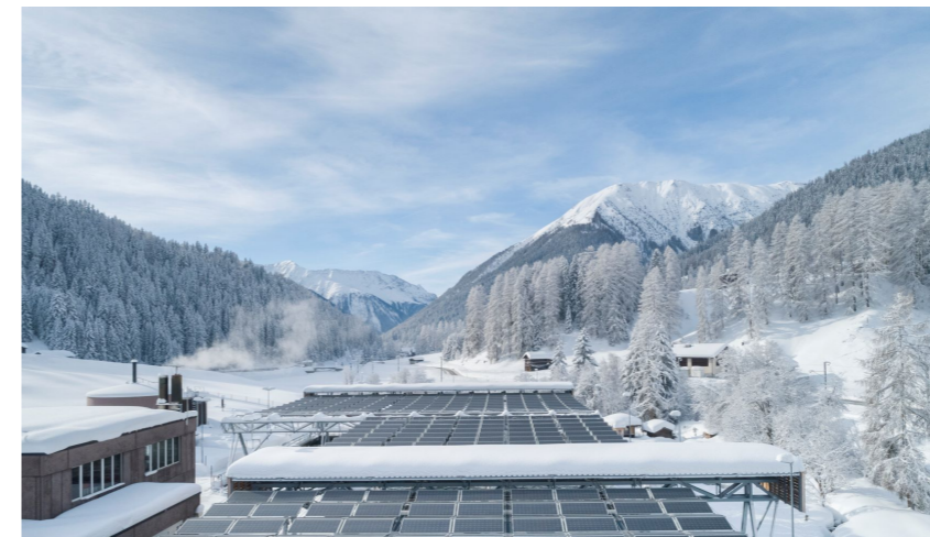
Das erste hochalpine Solarfaltdach – 252 kWp ARA Davos, 2022
